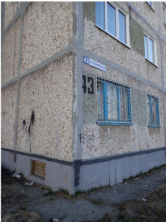
Удаление от угла здания около 20 см, высота размещения от земли более 2,7 м, размещено с левой стороны фасада.
