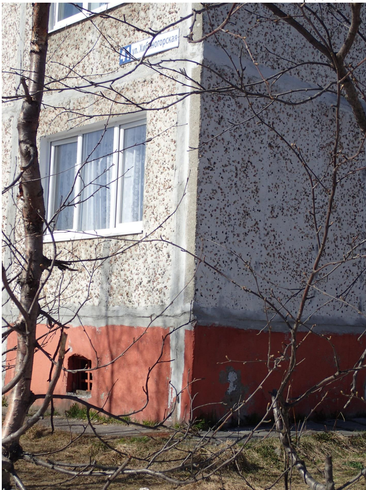
Удаление от угла здания около 30 см, высота размещения от земли более 3,5 м.
