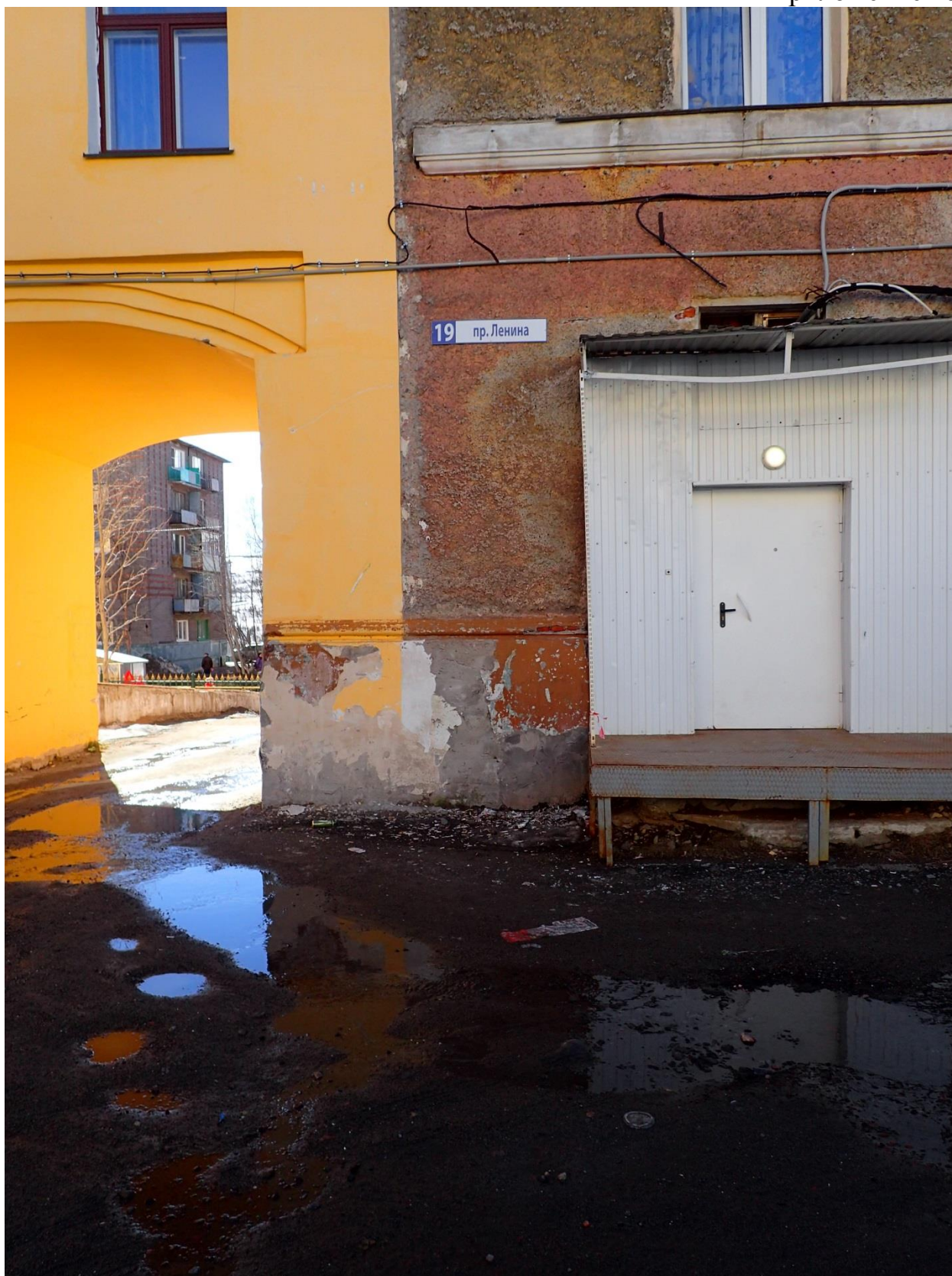
Удаление от угла здания около 1,5 м (от краски около 20 см), высота размещения от земли более 3,5 м, размещено с левой стороны фасада.
