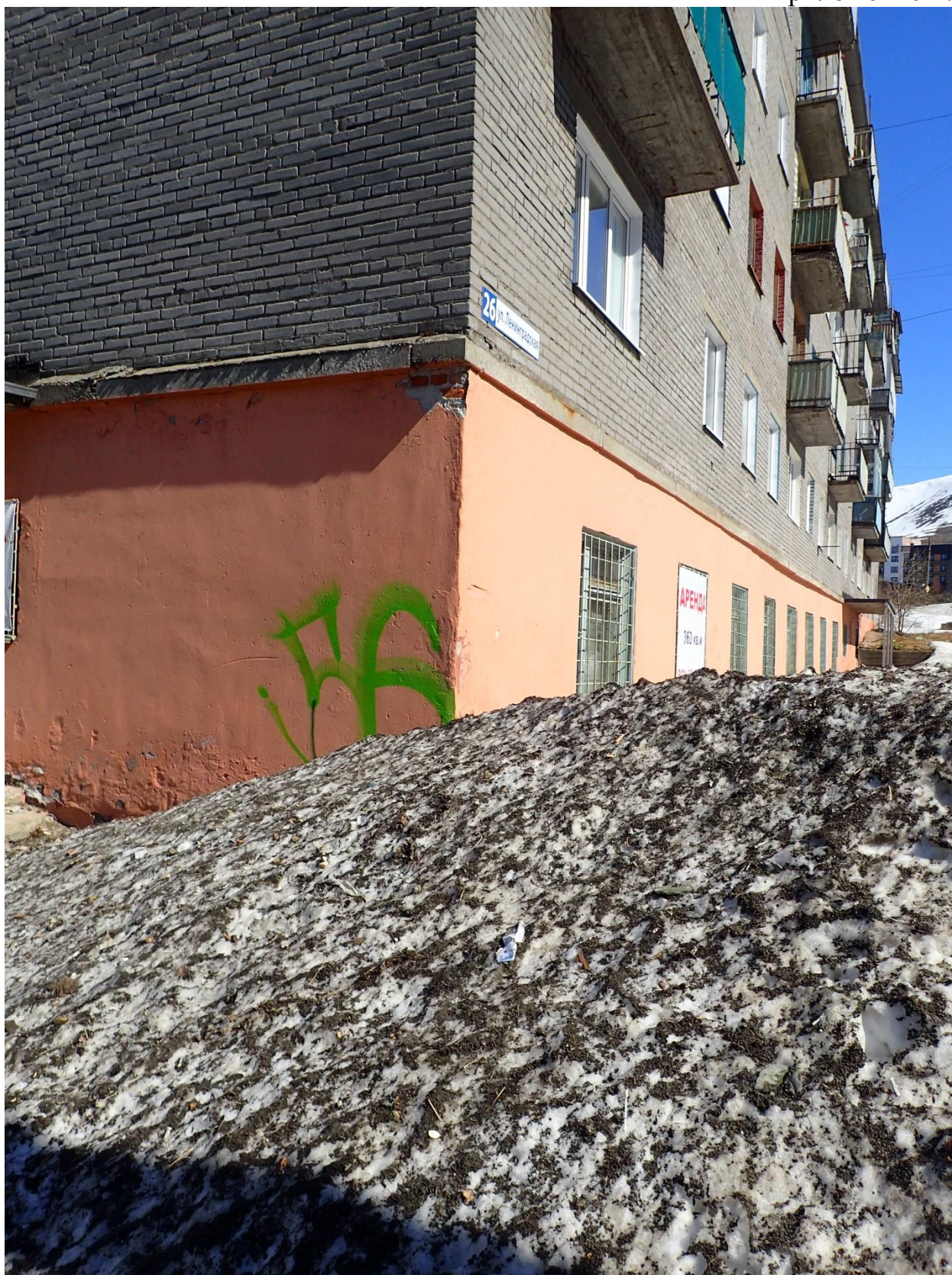
Удаление от угла здания около 10 см.
