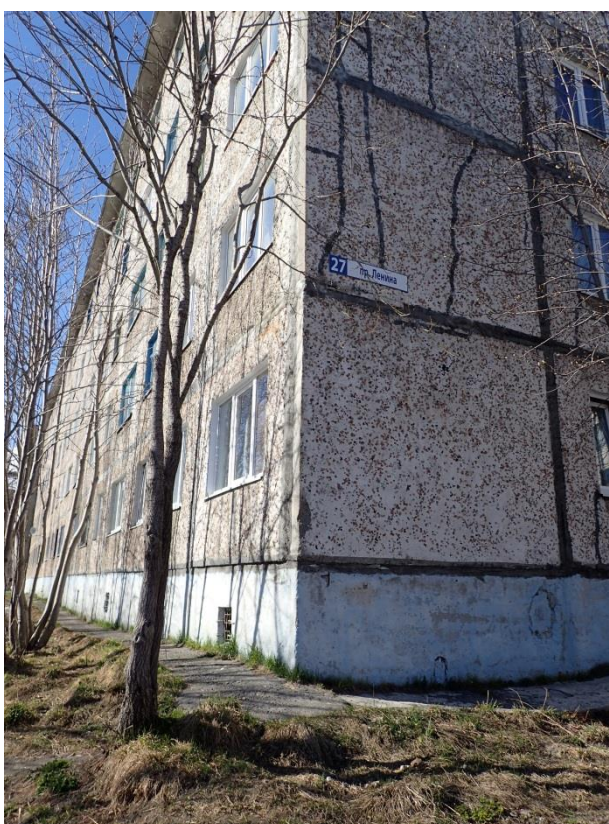
Удаление от угла здания около 20 см, высота размещения от земли более 3,5 м, размещено с левой стороны фасада.
