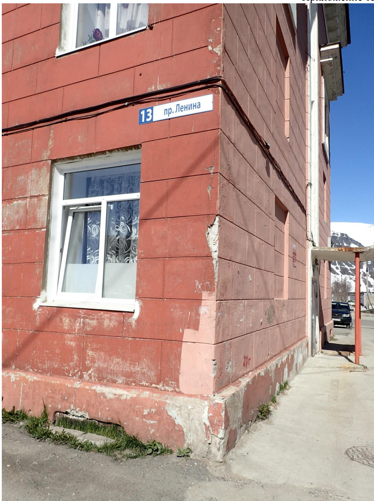
Удаление от угла здания около 10 см
